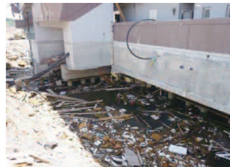
残存建築物周囲の洗掘状況
