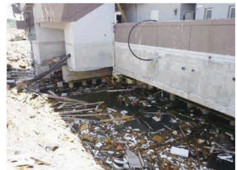
残存建築物周囲の洗掘状況
