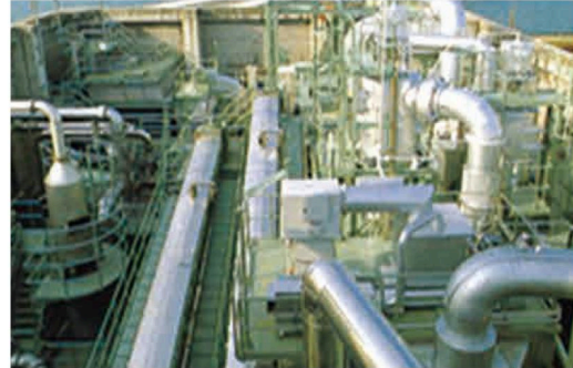
免震化を提案した上下水道施設
